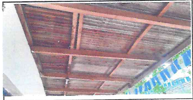
Foto 6: vigas en mal estado
