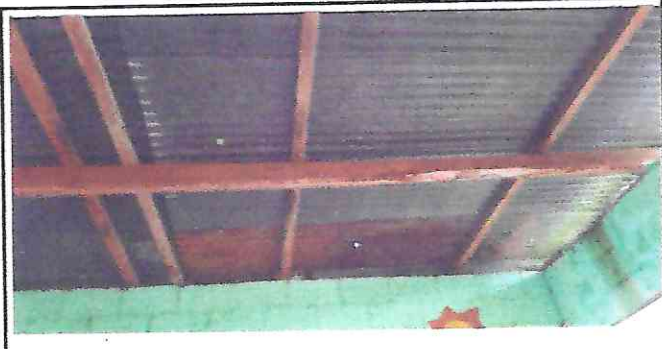
Foto 3: Techo de salón en mal estado
