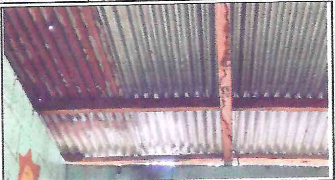
Foto 1: Lamina en mal estado
