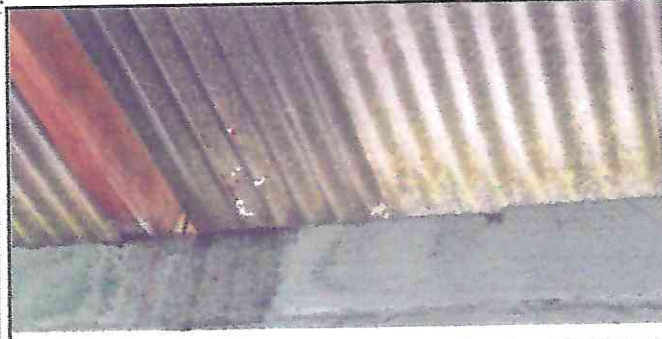
Foto 5: lámina en mal estado.
