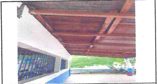
Foto 4: Techo en mal estado
