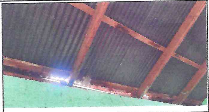
Foto 2: tendales en mal estado
